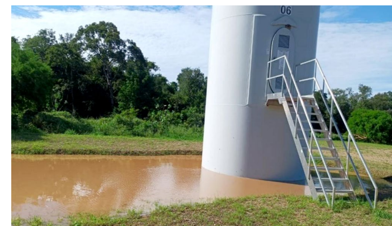
Situación crítica del sistema de drenaje del Parque Eólico El Dorado.
