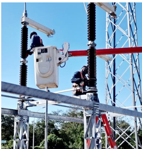
Transformador de potencia El Dorado y mantenimiento de subestación.
