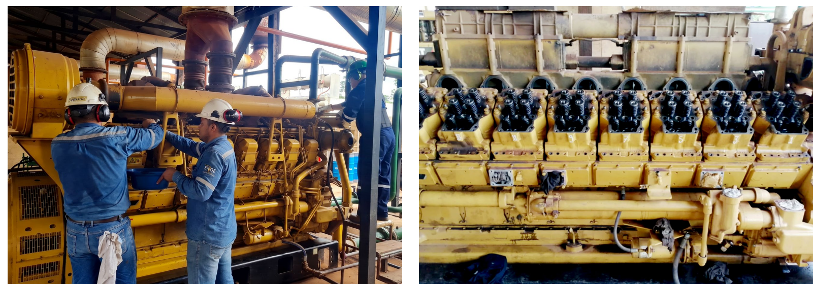
Mantenimiento TOP-END unidad 3516 Diesel.
