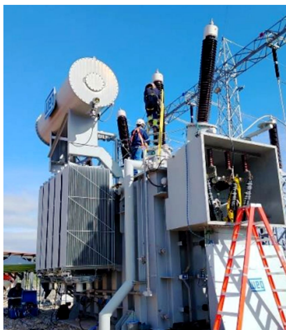
Transformador de potencia El Dorado y mantenimiento de subestación.
