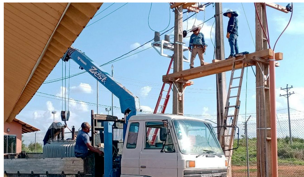
Subestación Eléctrica del Sistema Cobija.
