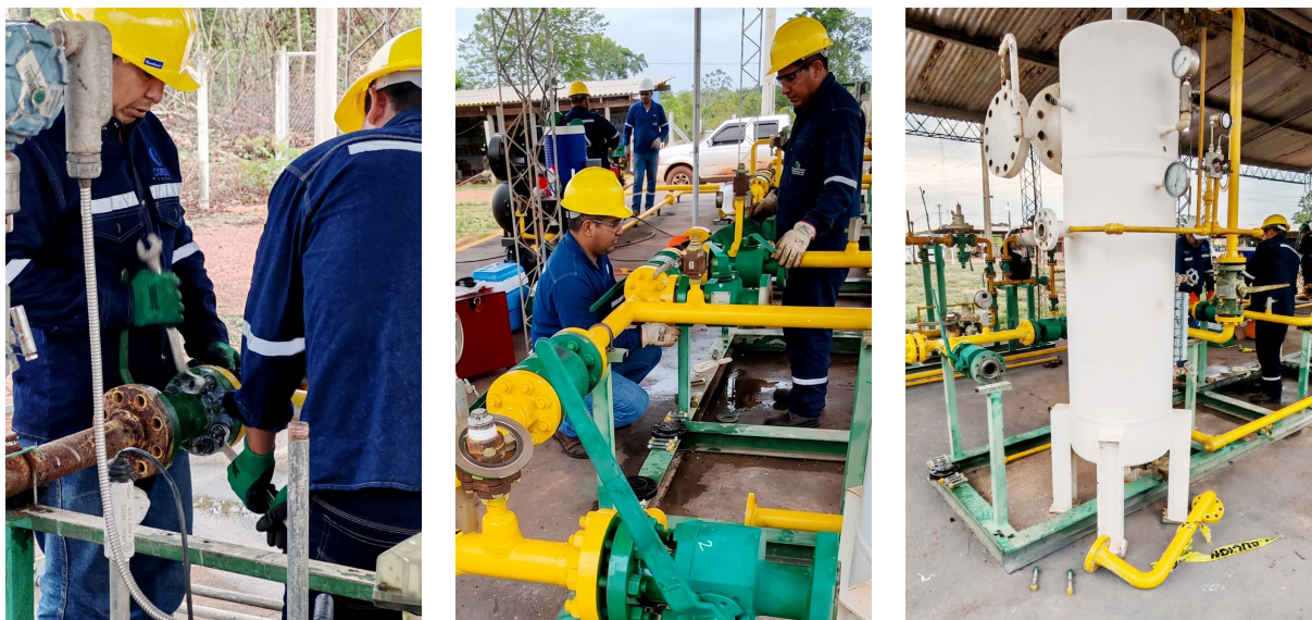
Mantenimiento subestación principal de gas.
