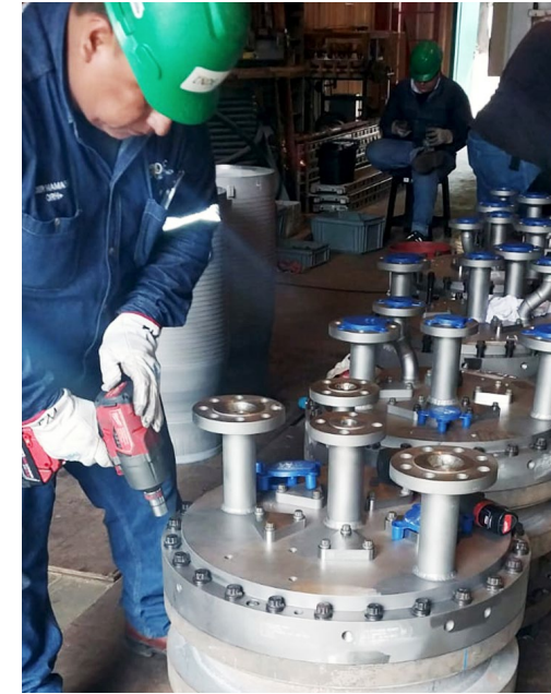
Mantenimiento cámaras de combustión e inspección boroscópica.
