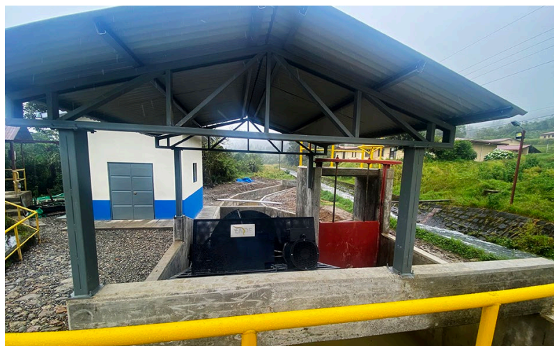
Vista casa de máquina – Hidrotornillo en Corani.
