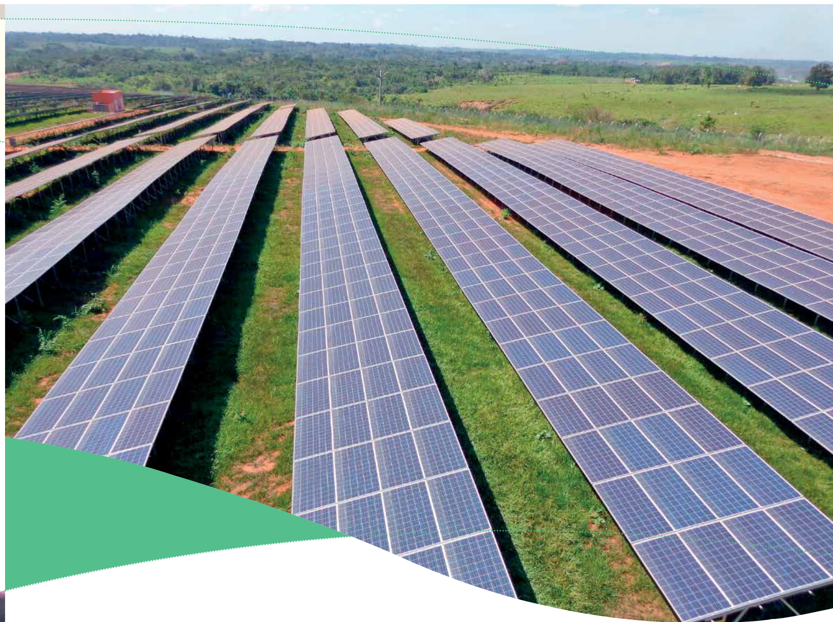
Planta solar fotovoltaica Cobija
