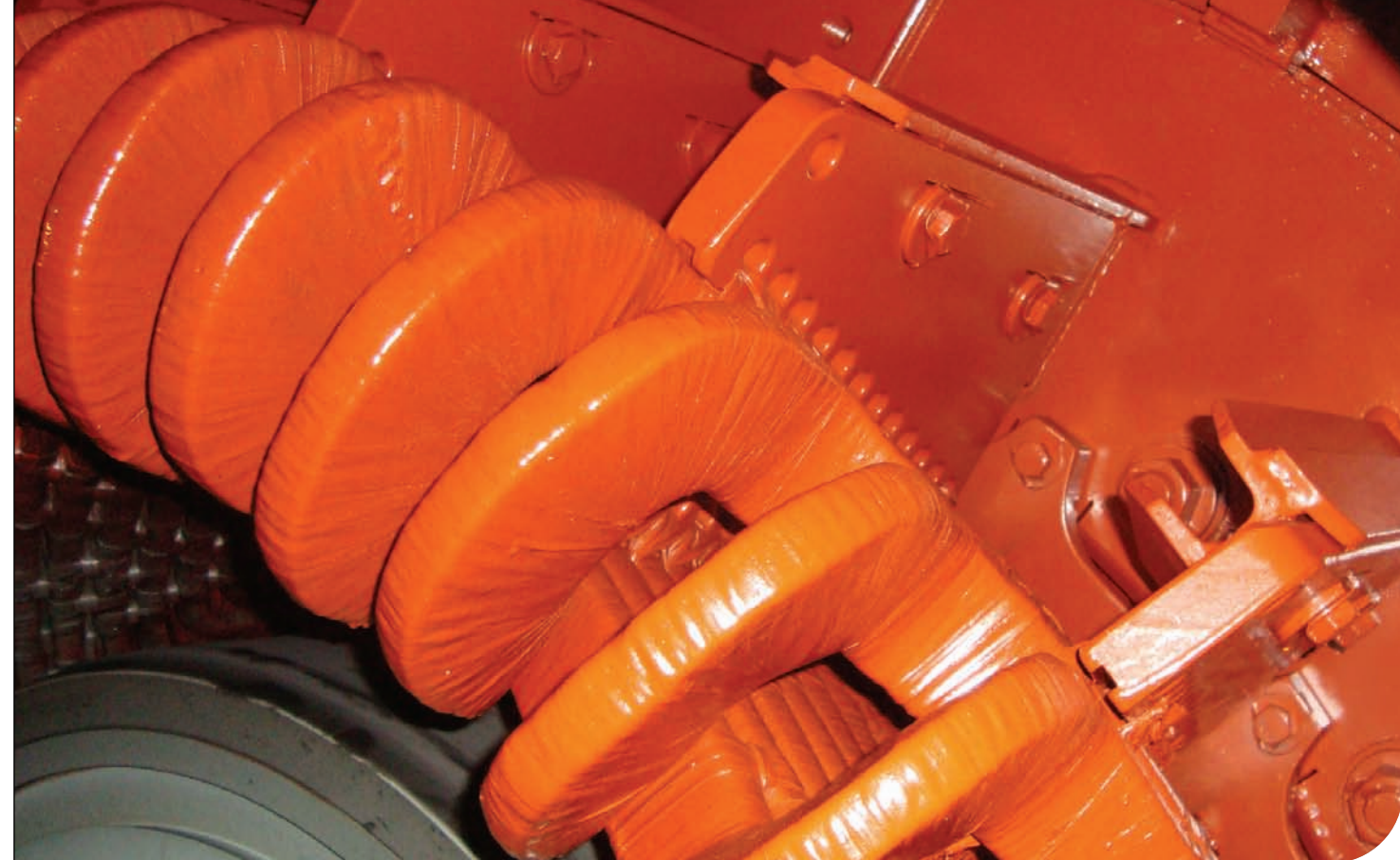
Cabezal de bobina de estator – Unidad GCH-12 – Ciclo combinado
