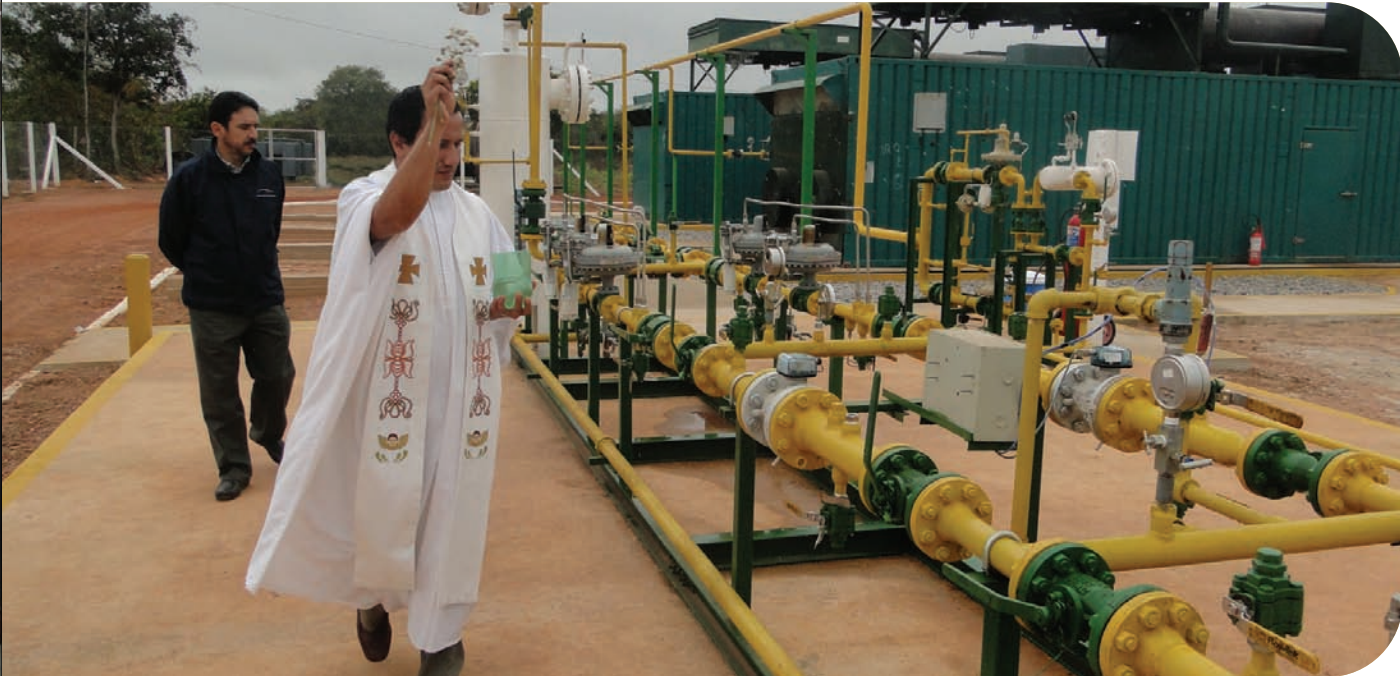
Bendición instalaciones Planta San Matías
