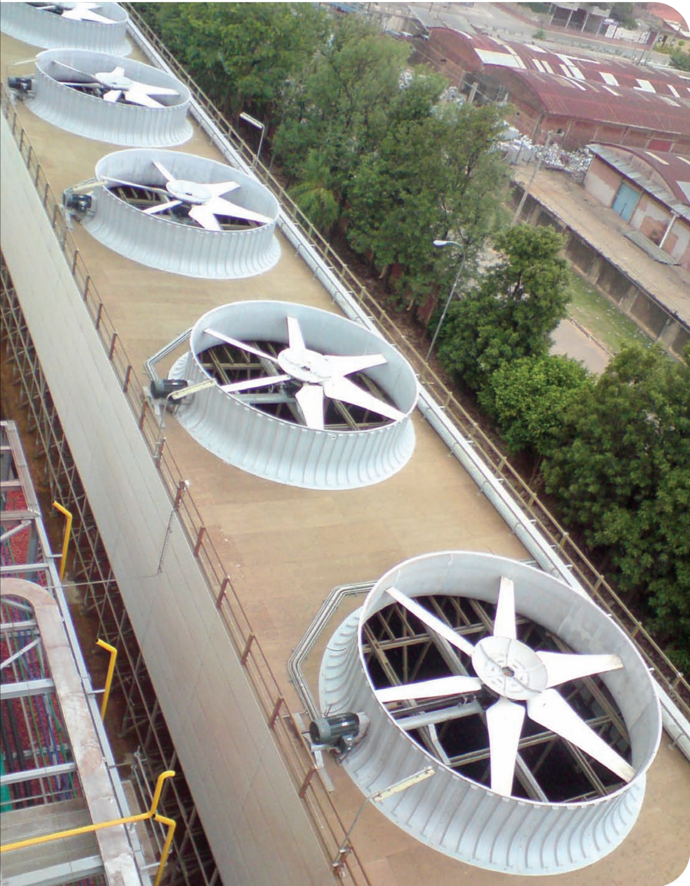
Torre de enfriamiento - Ciclo combinado
