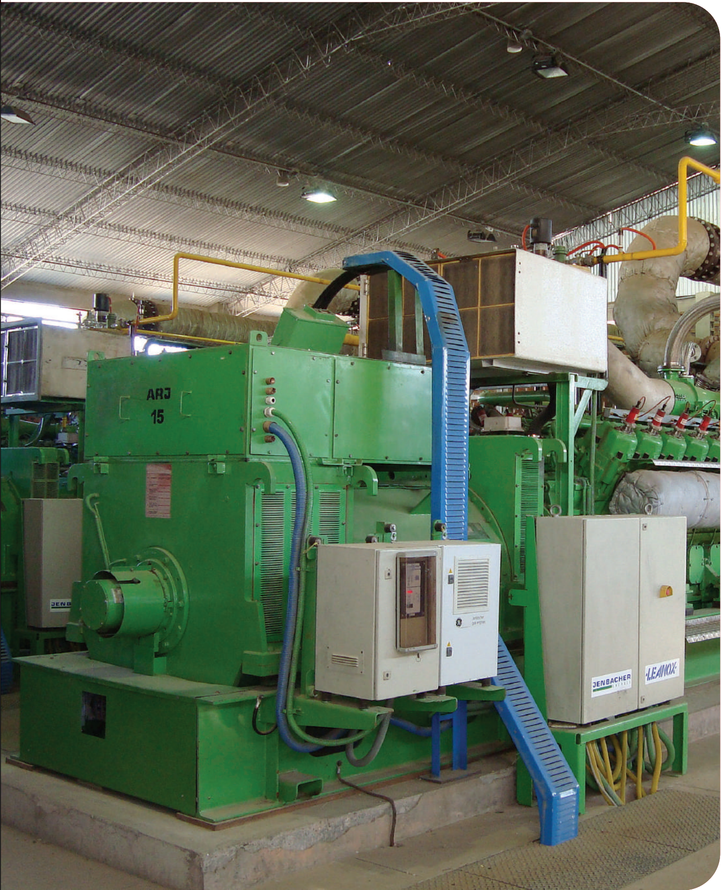
Motores Jembacher – Planta Aranjuez
