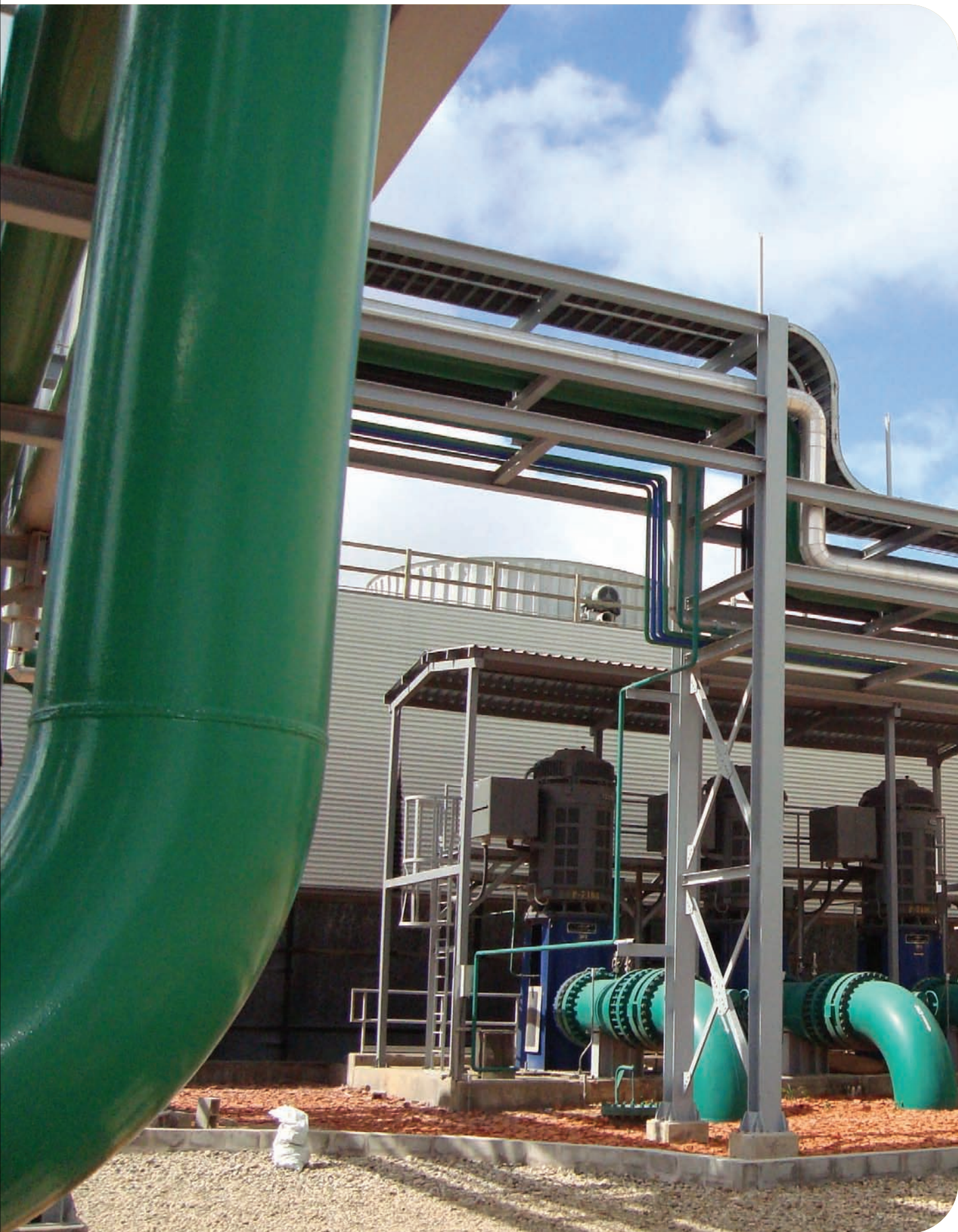
Bombas de agua torre de enfriamiento - Ciclo Combinado
