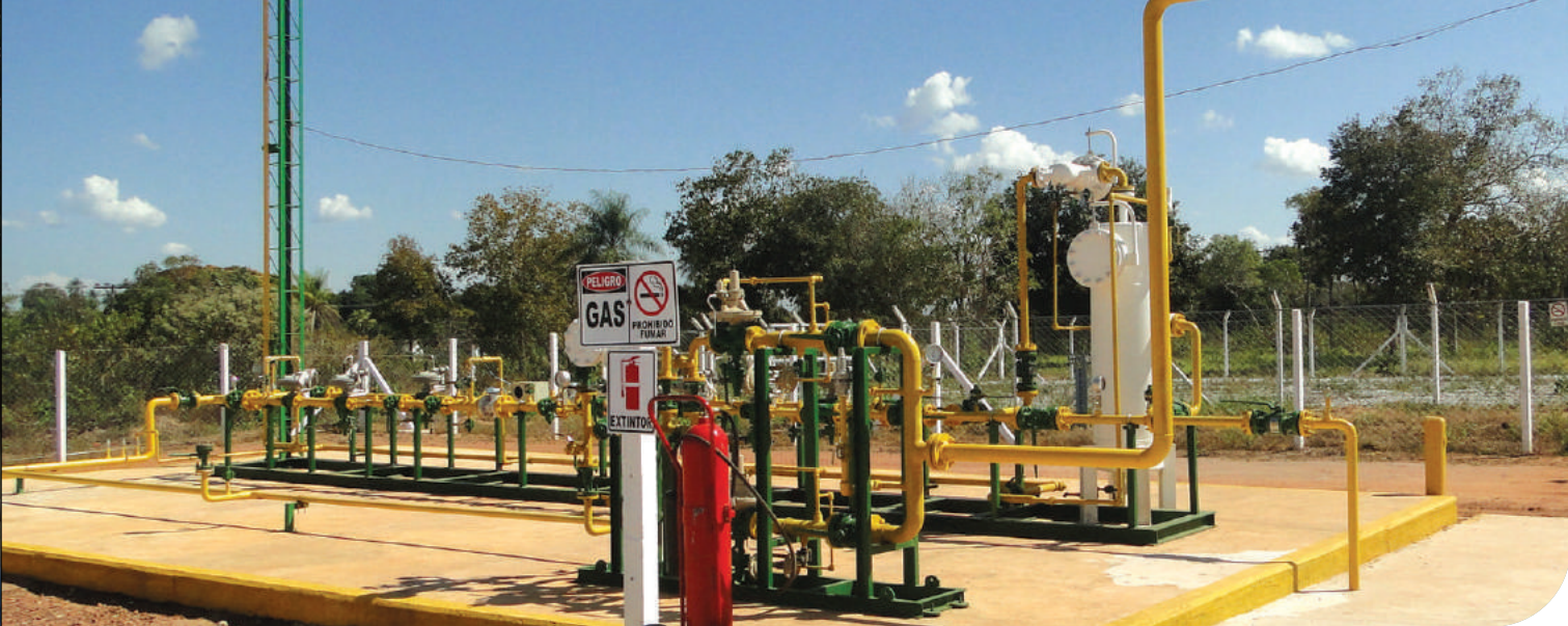
Subestación de gas – Planta San Matías
