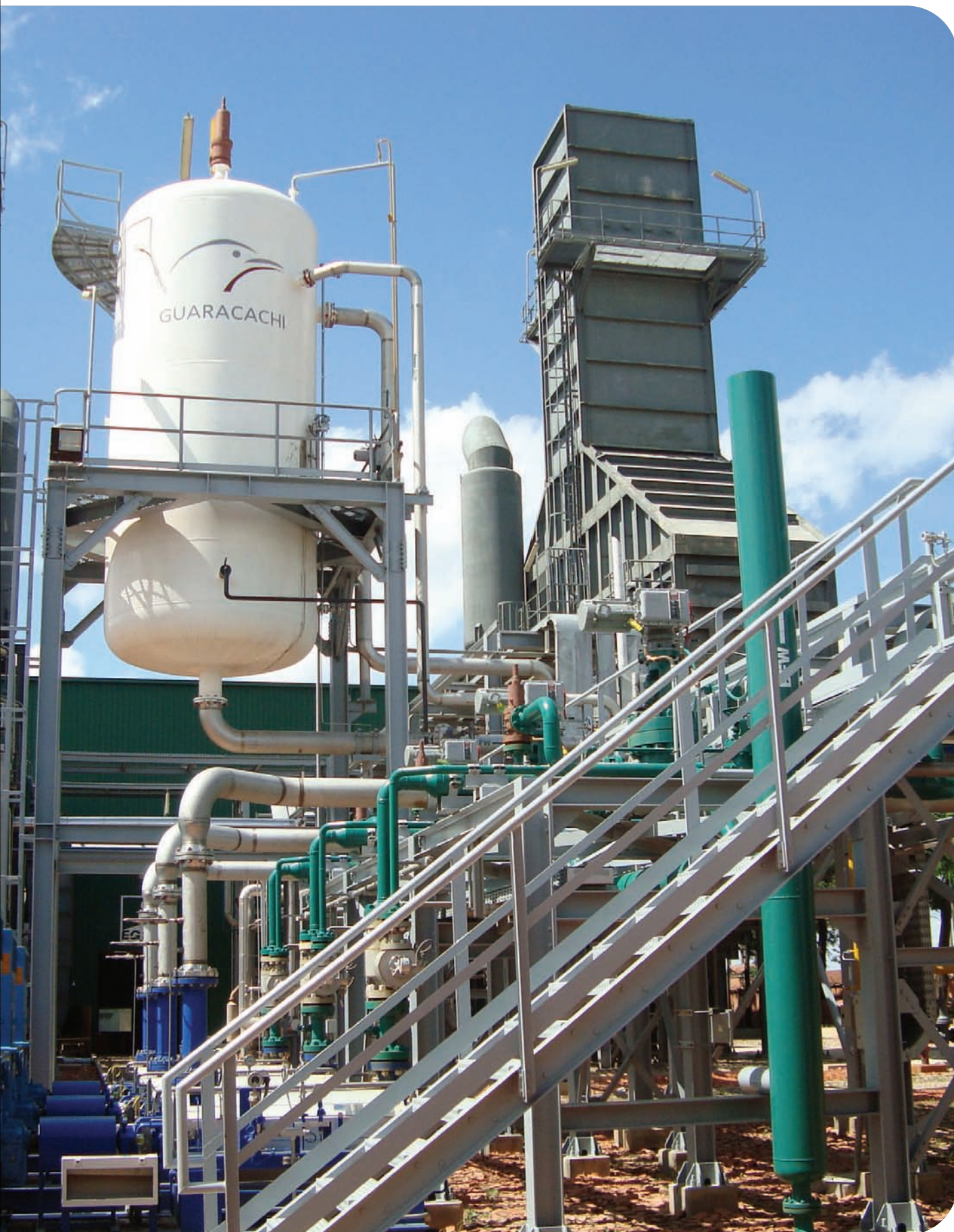
Tanque de almacenamiento de agua tratada – Ciclo combinado
