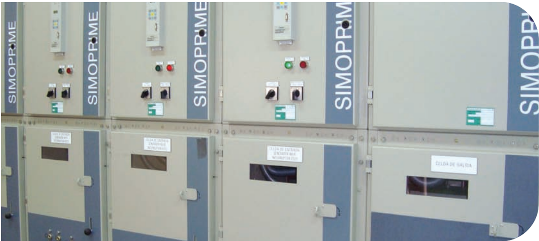
Centro de control de motores MCC – Ciclo combinado
