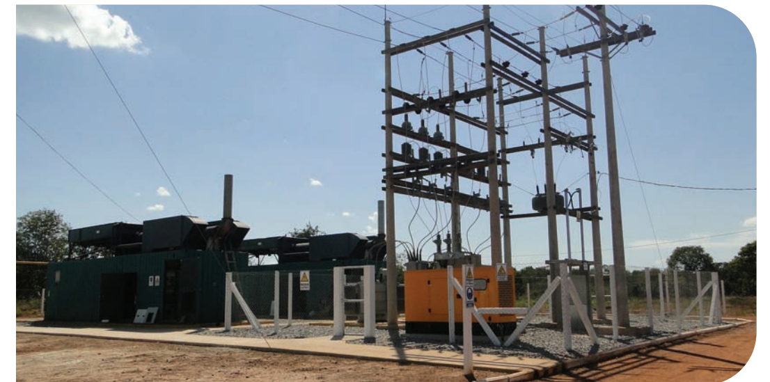
Motores y Subestación - Planta Termoeléctrica San Matías
