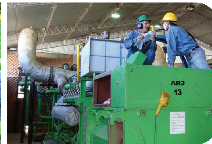
Mantenimiento Motores - Planta Aranjuez
