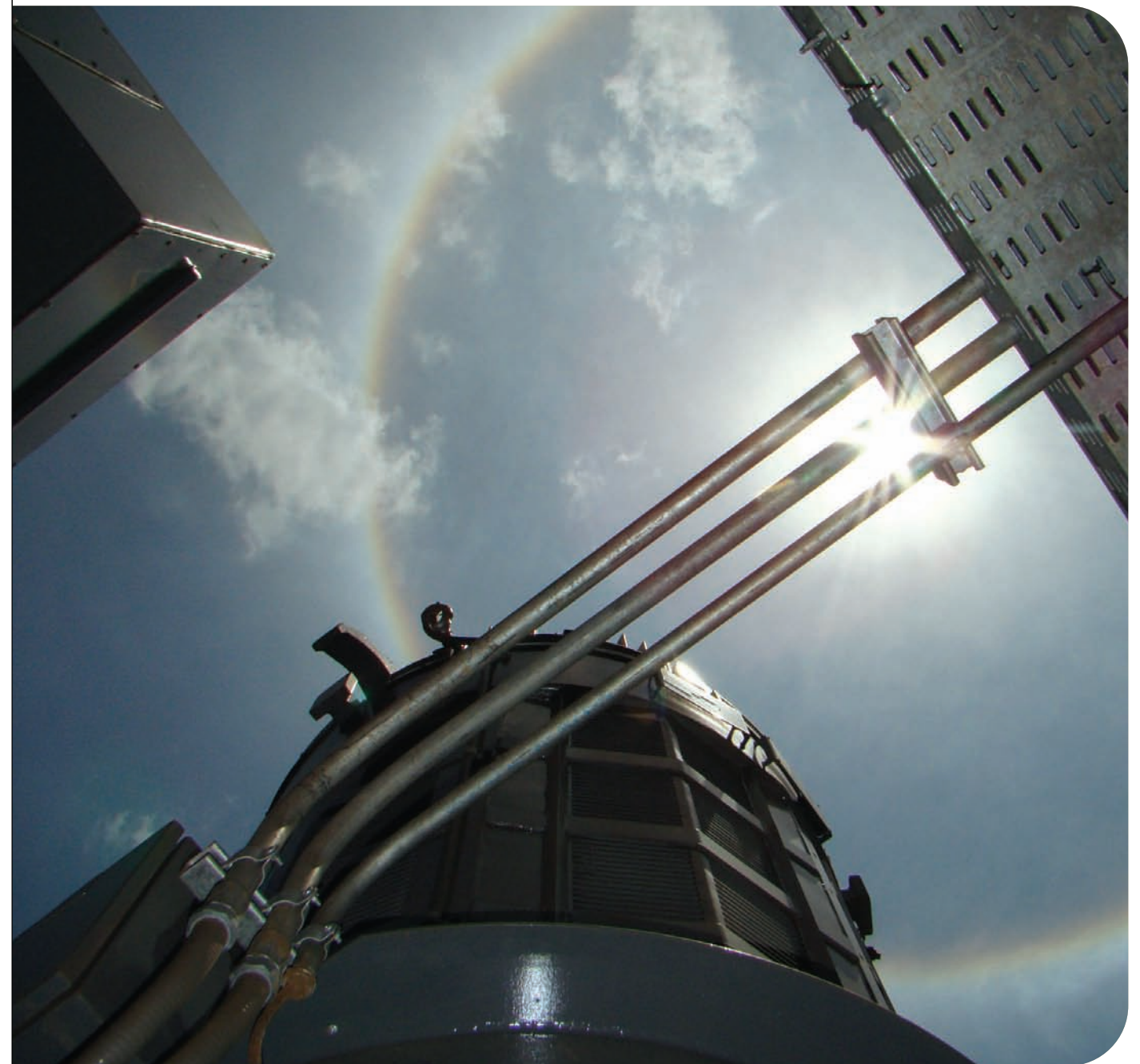
Bomba de agua de torre de refrigeración - Ciclo combinado
