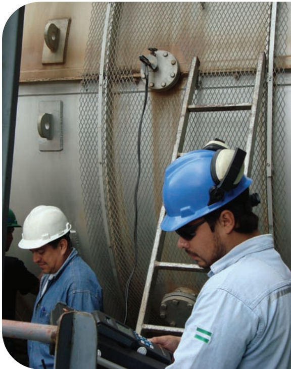
Medición emisiones de gases de combustión Planta Guaracachi
