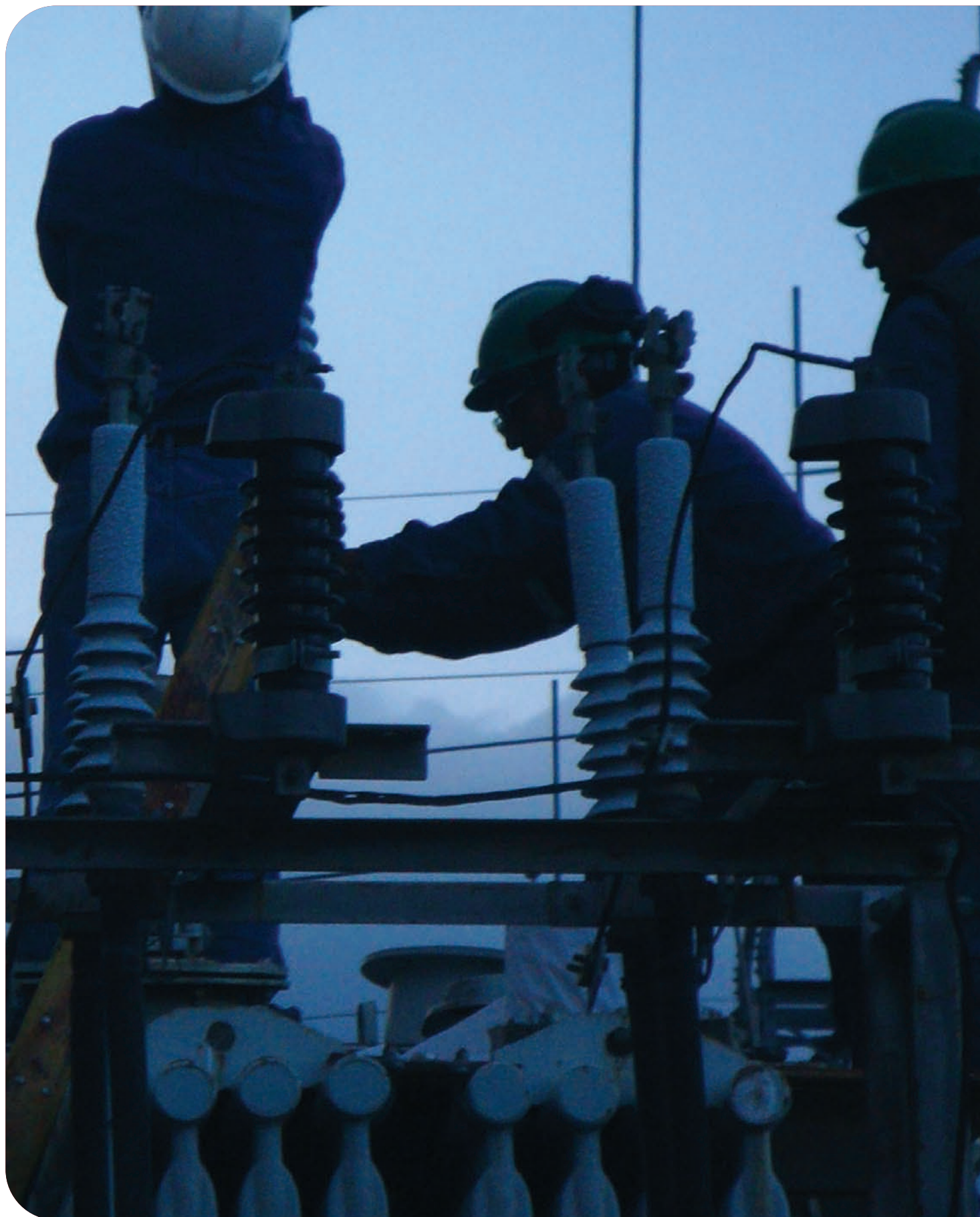
Mantenimiento de transformadores - Subestación Aranjuez
