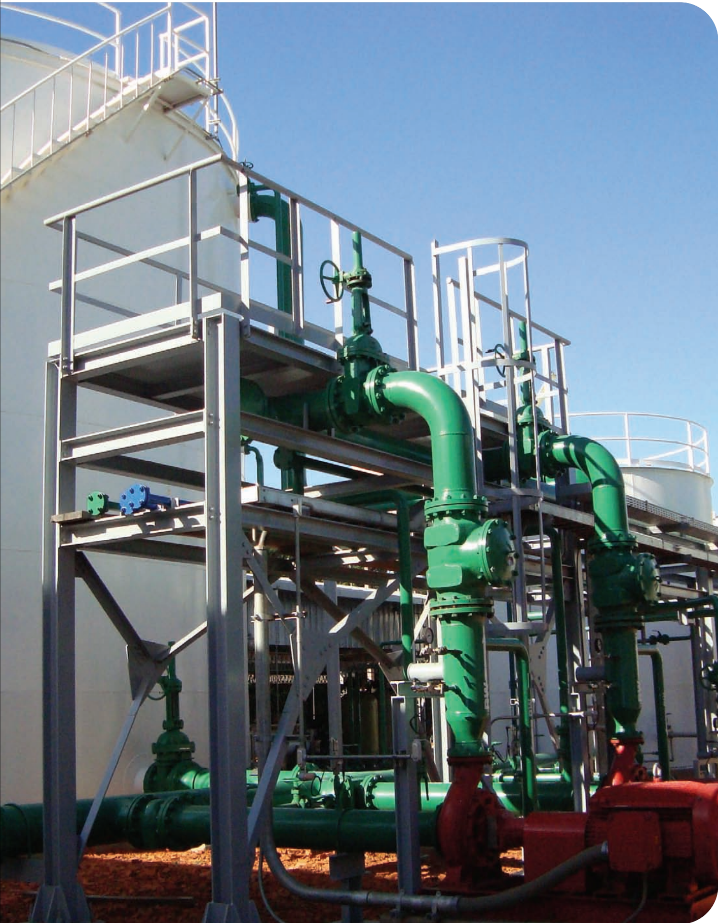
Bombas y tanques de almacenamiento de agua - Ciclo combinado
